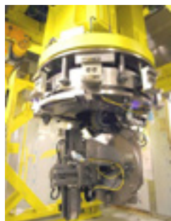
F9 Реактор с натриевым охлаждением: демонтажные работы на внутреннем оборудовании и на самом котле реактора.
